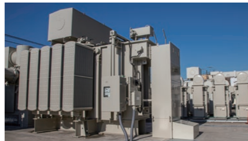
特高変電設備
